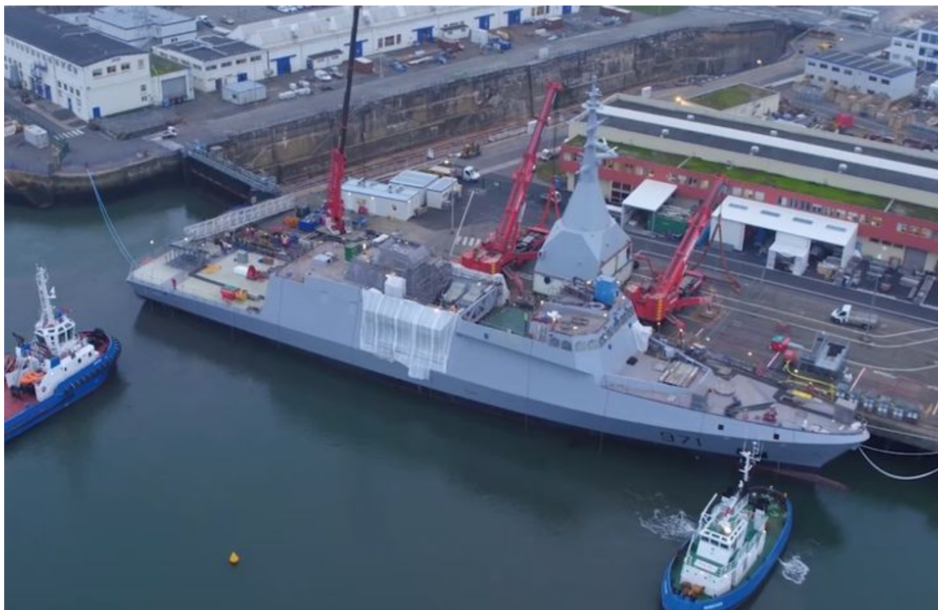
Gotowy moduł PSIM przed zamontowaniem na budowanym dla Egiptu okręcie Gowind 2500 - fot. DCNS
